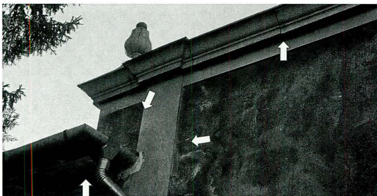
Pestújhelyi utcai oldal. A homlokzaton jelentős elszíneződés, sókiülés látható a vízvezetés rendezetlensége miatt. Az ereszcsontra régebbi, az ejtőcsövet cserélték. A műkö elemeknél elmozdulás mutatkozik.
