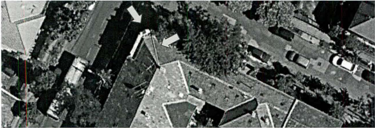
Az épület sarkánál alaprajzi letörés helyezkedik el, melyet a tetőidom is lekövet. Ezen letört tetőszakaszon nem cserepezés, hanem deszkázatra készített korcolt bádogfedés található.
