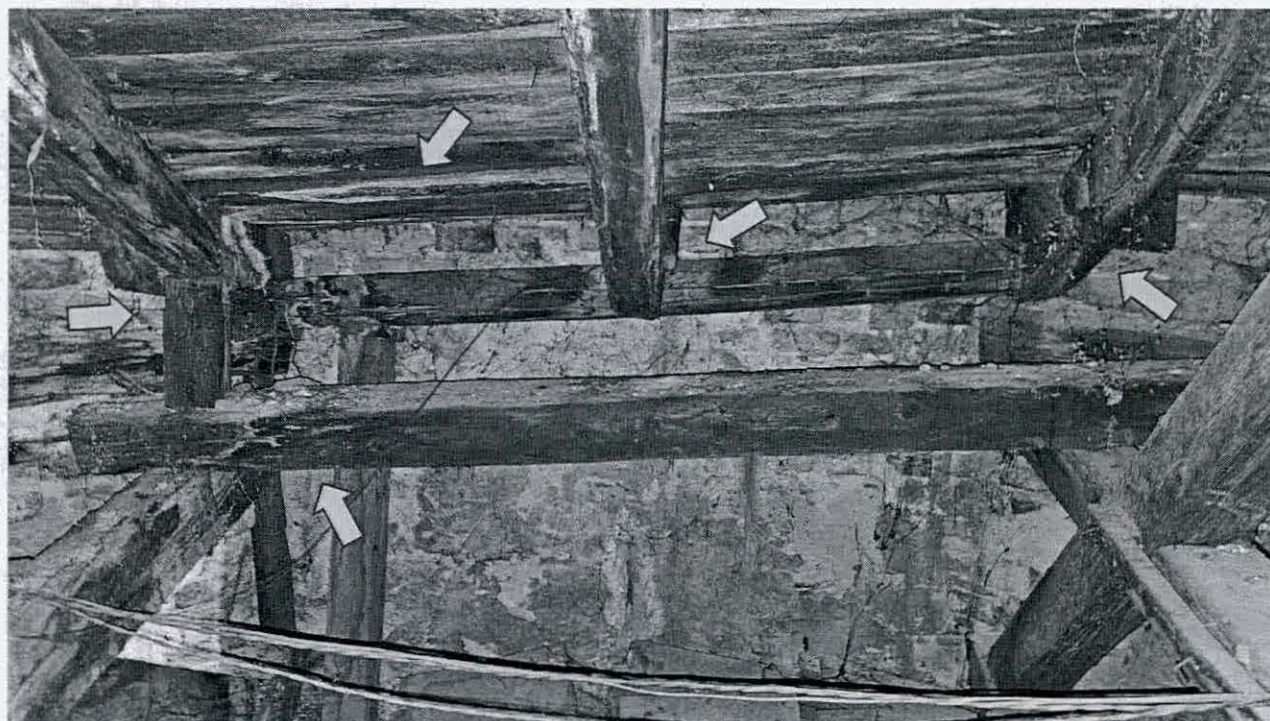
Sarki rész a padlástérből. A lefutó szarufákon, élszarukon, deszkázaton, alátámasztó oszlopon, szelemeneken leázásra utaló elszíneződés és korhadás jelei láthatók. Cserepeken elszíneződés, salétromosodás látható. A cserepezés és bádogozás közötti váltásnál kilátni, hézag van.
