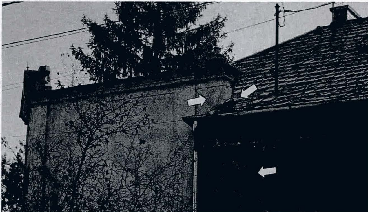
Molnár V. utcai oldal. A homlokzaton jelentős elszíneződés, sókiülés látható a vízvezetés rendezetlensége miatt. A bádogozás több helyen meggörbült a faltól elvált. Az attika végénél ferde repedés mutatkozik.
