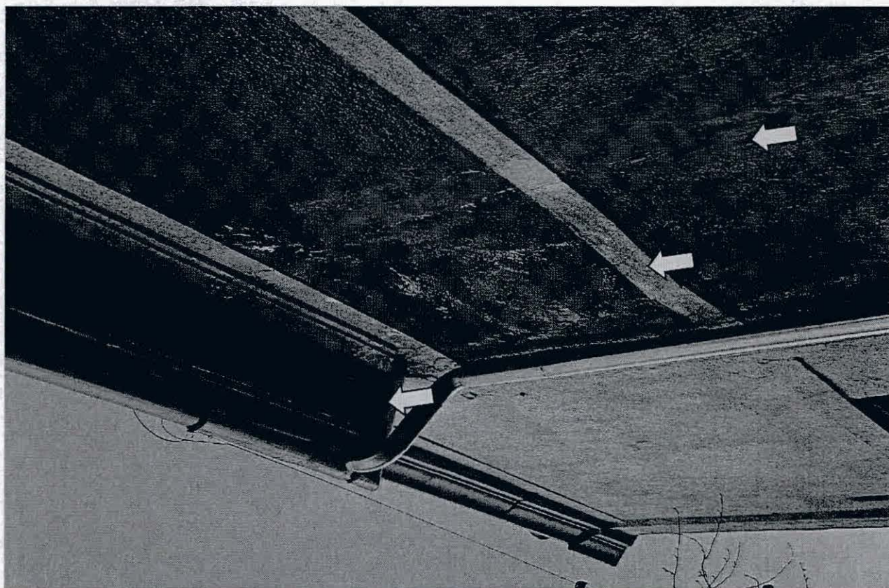
Molnár V. utcai oldal. A homlokzaton jelentős elszíneződés, sókiülés látható a vízvezetés rendezetlensége miatt. Az ereszeszkázat alsó része ezen szakaszon a leázások miatt károsodott, alulról utólagosan lett javítva. Az ereszcatorna és ejtőcső nemrégén lett cserélve.
