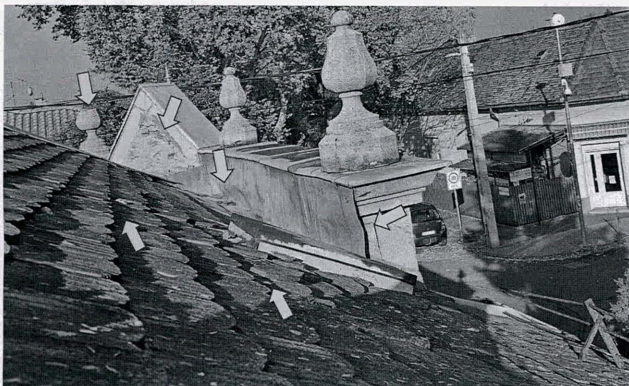
A cserepezés több helyen töredezett, elmozdult, törmelék van rajta. Az attikafalon lévő bádogozás több helyen erőteljesen meggörbült, elmozdult. Az attikafal hátsó felületén a felázás miatt a vakolat szétfagyott, levált.
