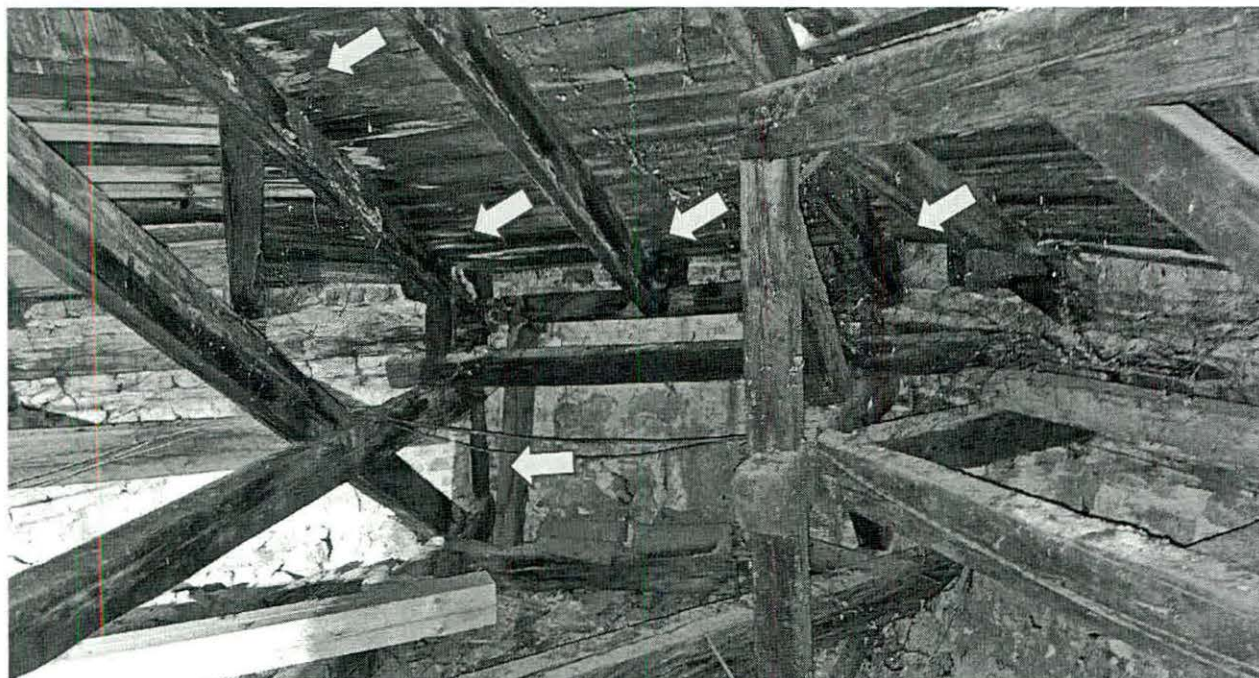
Sarki rész a padlástérből. A lefutó élszarukon, deszkázaton, alátámasztó oszlopon leázásra utaló elszíneződés és korhadás jelei láthatók. A bal oldali részen a vízszintes fogófát kis keresztmetszetű dúccal támasztották meg. Cserepeken elszíneződés, salétromosodás látható. A cserepezés és bádogozás közötti váltásnál kilátni, hézag van.
