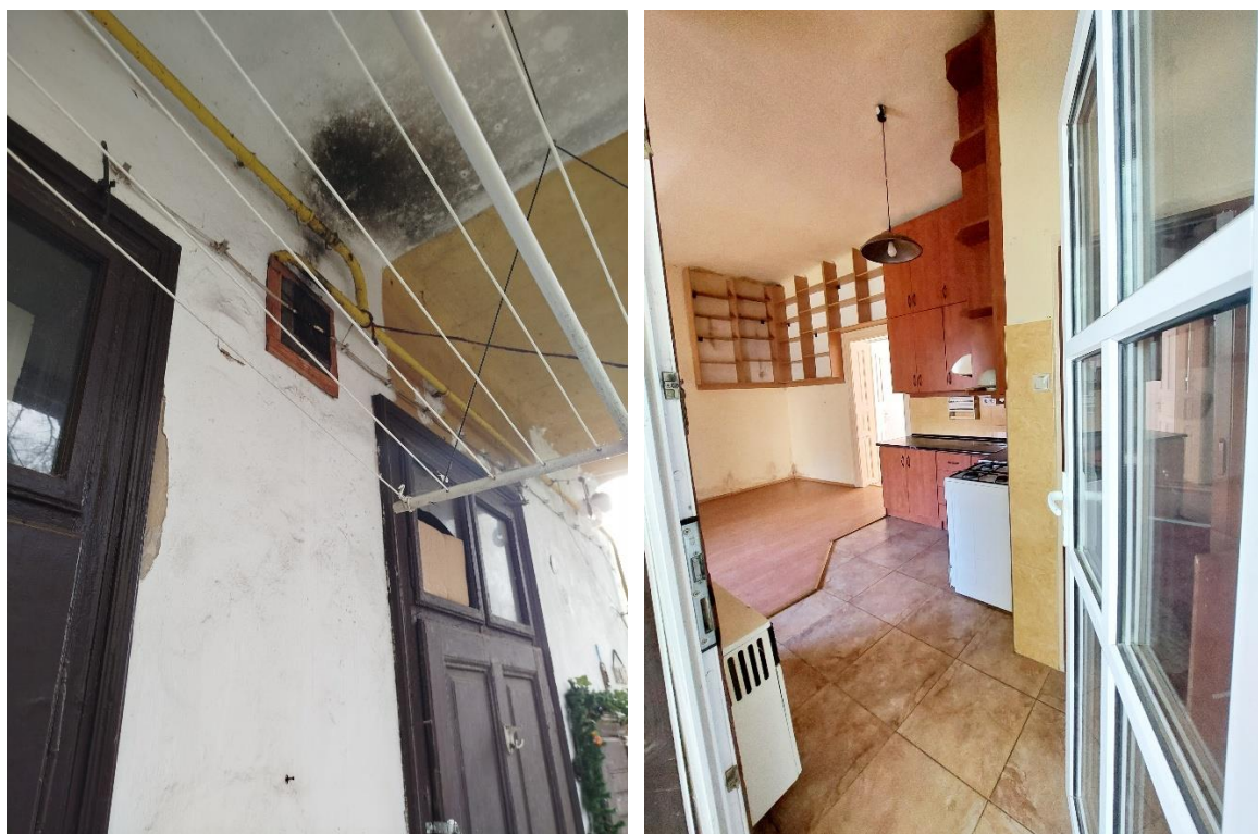
Fsz. 2 lakás fürdőszobájának homlokzati szellőzőjénél penészedés alakult ki.
