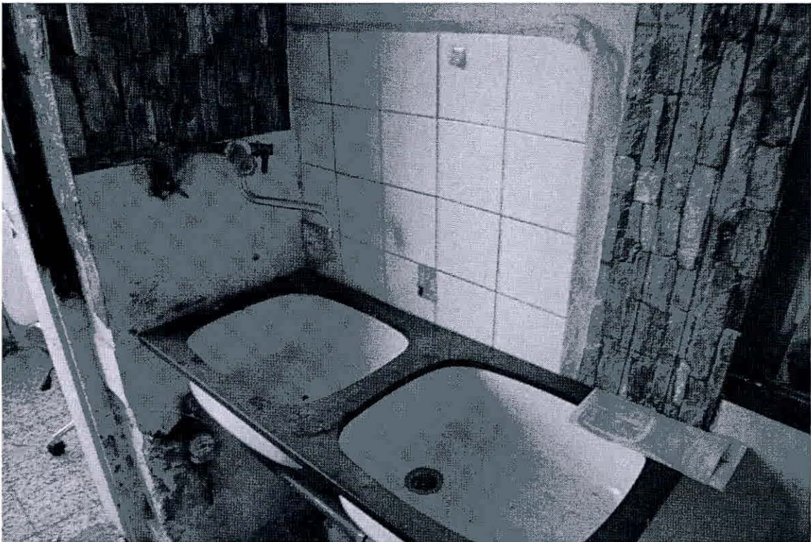
Fsz. 1. lakás. A konyhai mosogatót a folyosón helyezték el. A vízóra mellett a fal nincs helyreállítva, a burkolat hiányos, koszos, elavult.
