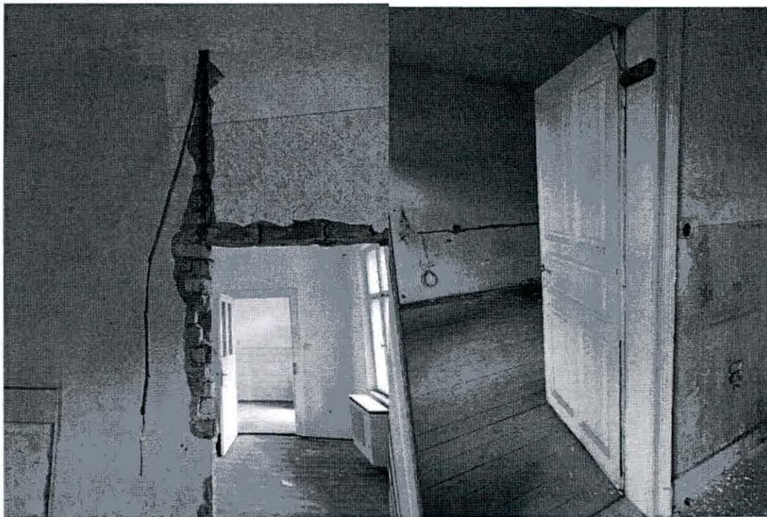
Fsz. 4. lakás. Nem szabványos elektromos hálózat, valamint elavult padló és falburkolatok. A kivágott nyílás falzatába nem helyezték el az áthidaló gerendát.
