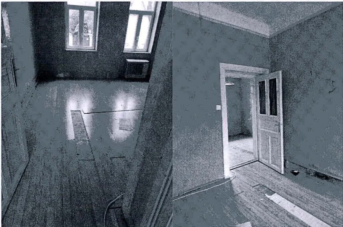
Fsz. 2 lakás Szobai laminált parketta burkolat hiányos, az oldalfalon vízesedés nyoma látható.
