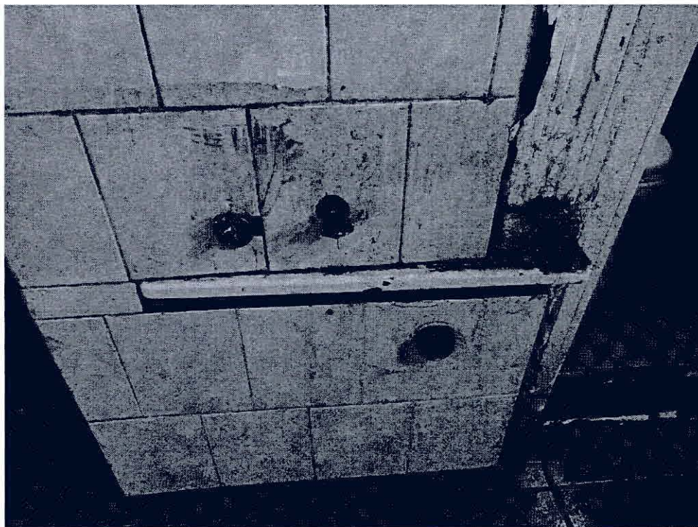
Fsz. 2. lakás fürdőszoba, szakszerűtlen kádbeépítés. A kád túlnyúlik a határoló fal síkján.
