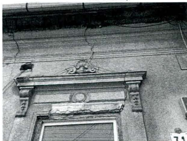
04. repedések a homlokzaton
