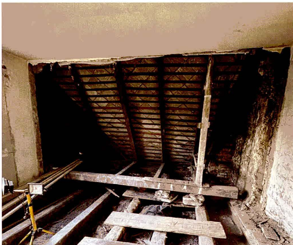
3.sz. kép: Hiányzó kötőgerenda a jobb oldalon. Fiókváltó vége a levegőben. A fiókváltó vége egy deszkával lett kitámasztva a középszelemenhez. Veszélyes állapotú tetőszakasz!
